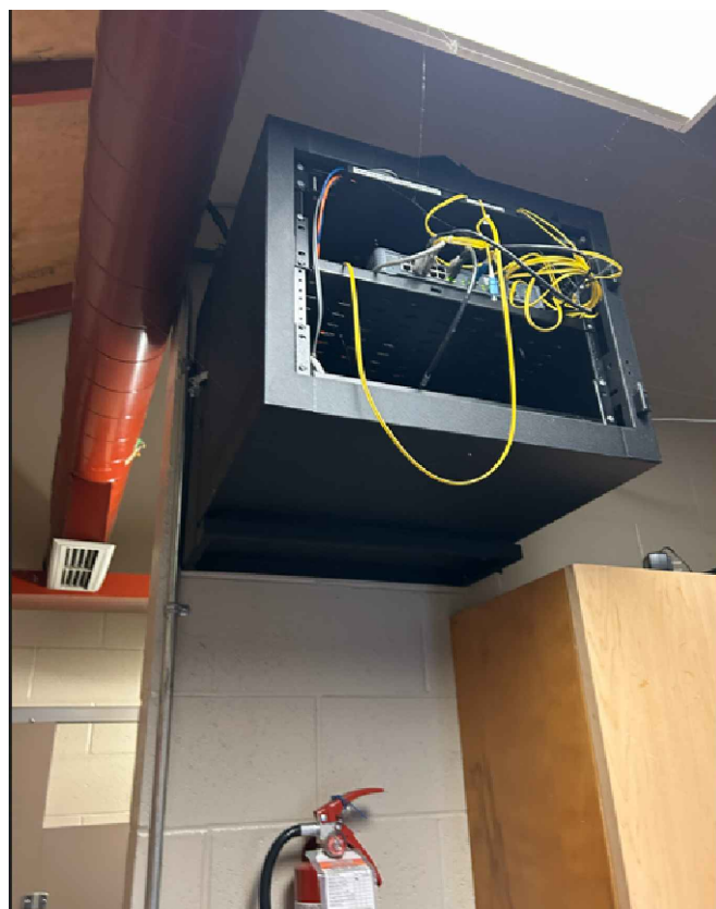
3 EXISTING DATA RACK SCALE: N.T.S.
